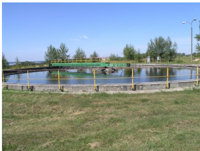
Osadnik wtórny w oczyszczalni w Maszewie
