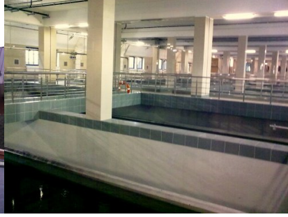
Hala filtrów węglowych
