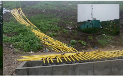
Instalacja zbierająca gaz składowiskowy
